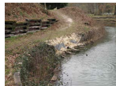
Δ Terrasse affaissée
